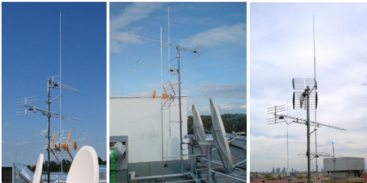
Fot. 3. Antenowa instalacja zbiorowa wraz z ochroną odgromową.
