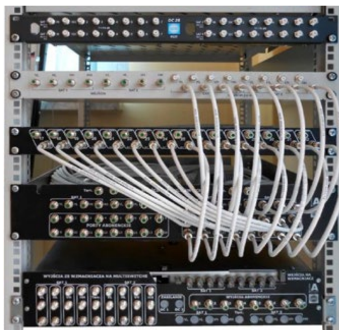
Fot 5. Punkt Styku (punkt kolokacji urządzeń).
