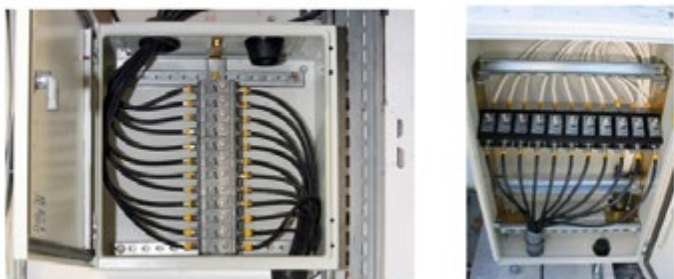
Fot. 4. Szafki z ogranicznikami przepięć do ochrony instalacji antenowej.
