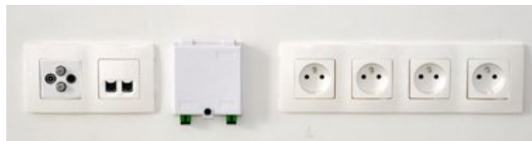
Fot. 2. Zakończenia kabli w lokalu mieszkalnym, zgodnie z rozporządzeniem Warunki Techniczne.
