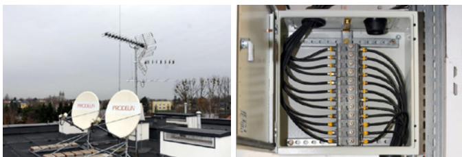
Fot. 1. Elementy instalacji teletechnicznej na osiedlu Sklepowa 22: a) pole antenowe, b) ograniczniki przepięć
