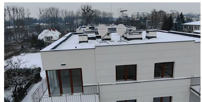
Fot. 3. Pole antenowe na budynku w osiedlu Skłepowa 22 (kliknij, by obejrzeć film!)
